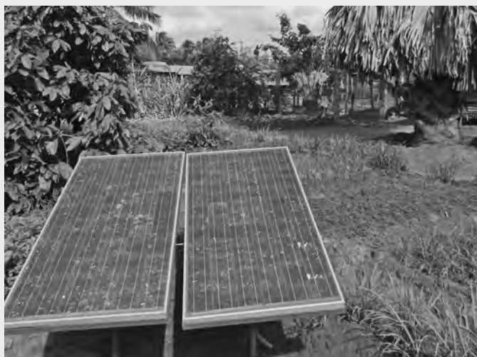
Panneau solaire au Centre Songhaï (Bénin), Photo: ENERGIES 2050
