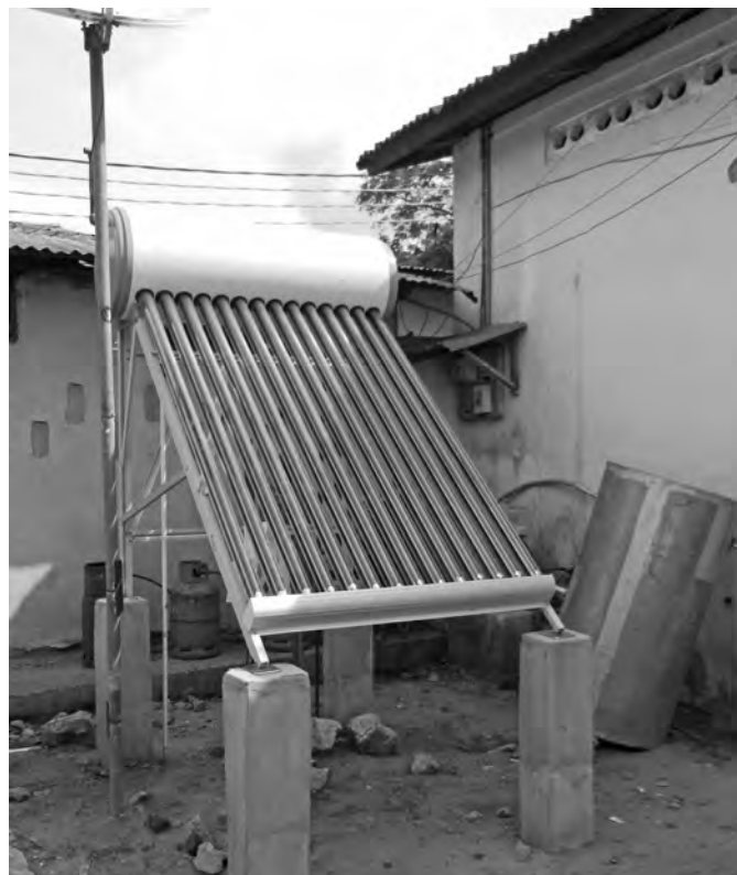
Installation du Centre Songhai (Bénin), Photo : ENERGIES 2050
